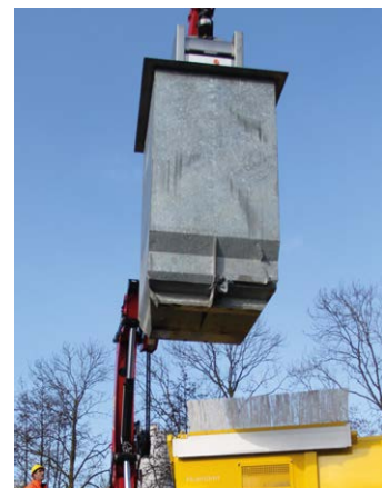
De prijzen van koudgewalst staal, nodig voor bijvoorbeeld ondergrondse containers, zijn bijna verdubbeld.
